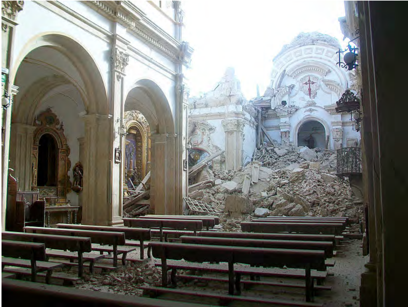
Hundimiento de la iglesia de Santiago tras el terremoto de Lorca
