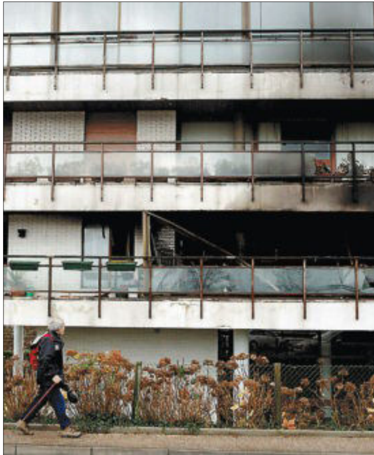
Fachada del edificio en el que se produjo el incendio en Hondarribia. / EFE
