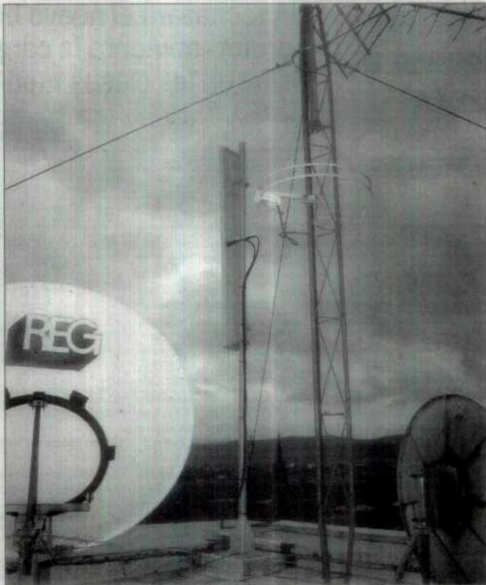
Imagen de dos antenas parabólicas y una torre de telefonía instaladas en Vitoria.
