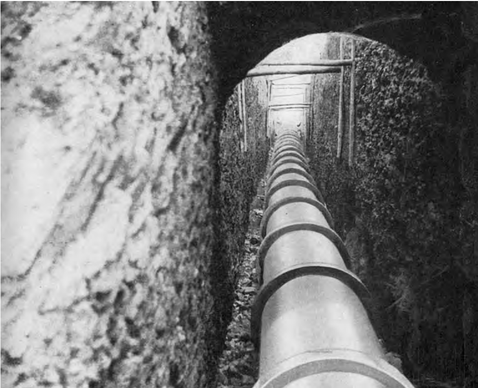
Tuberías de aguas desde el depósito de Larraskitu.
