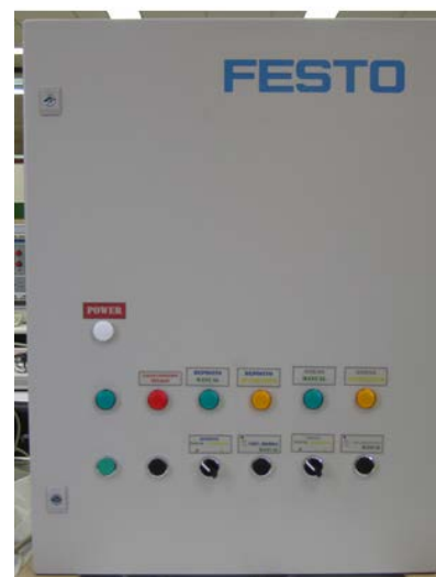
Figura 10. Frontal del armario de control
