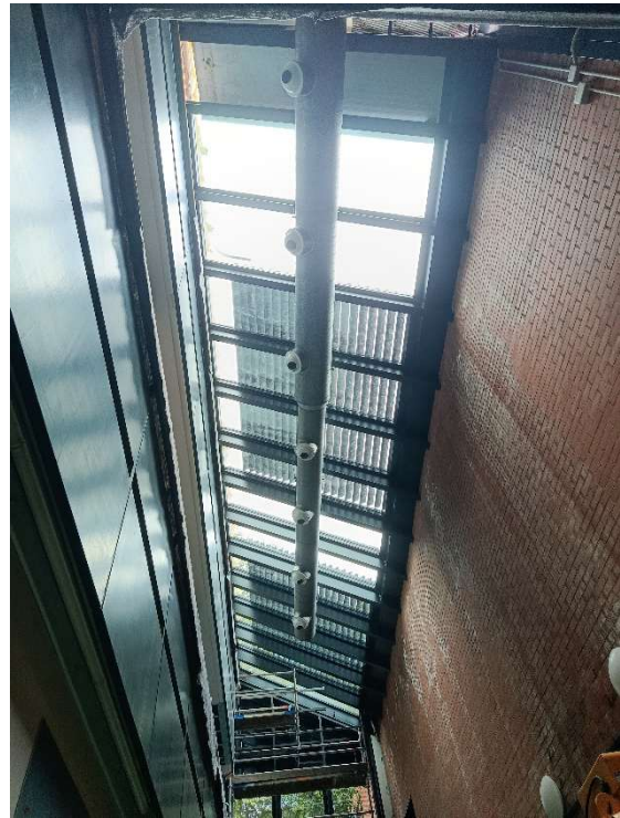
Figura 55. Lucernarios instalados junto con las protecciones solares.
