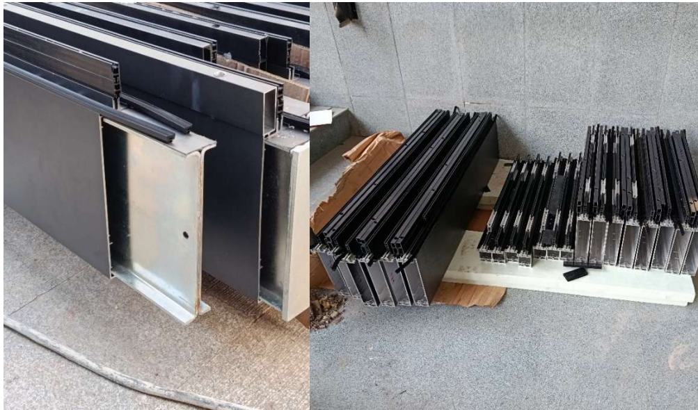
Figura 11. Perfiles reforzados y sin reforzar para el muro cortina (fotografía tomada durante la visita de obra).
