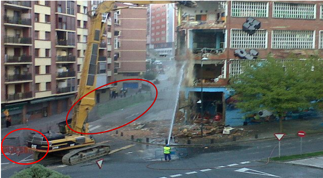
El perímetro solo está vallado por un lado del edificio.
